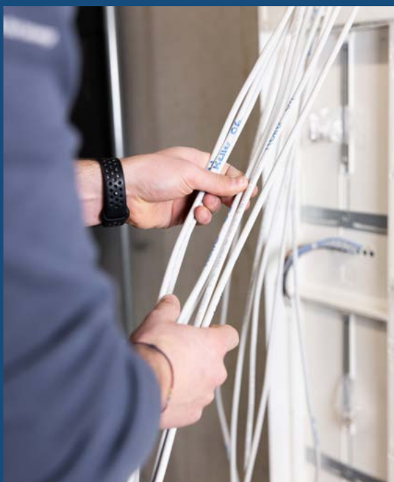
Wichtig: Korrekte Kabelzuordnung zu den Sicherungsgruppen.
